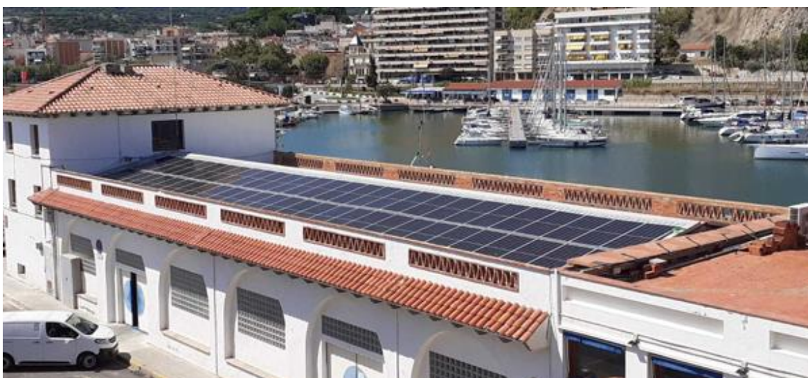
Plaques fotovoltaïques a la coberta de la llotja de peix blau.
