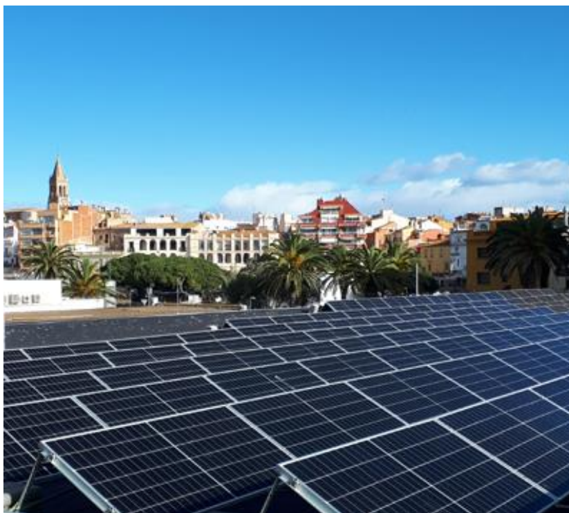
Plaques solars a la coberta de la llotja de Palamós.
